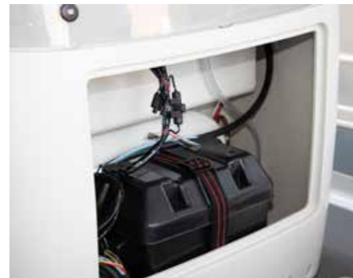
Die Starterbatterie ist bestens zugänglich im Frontbereich der Fahrkonsole installiert
